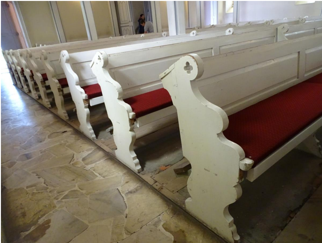
Fot. 28 Uszkodzenia drewna spowodowane żerowaniem owadów oraz wstawki drewna
