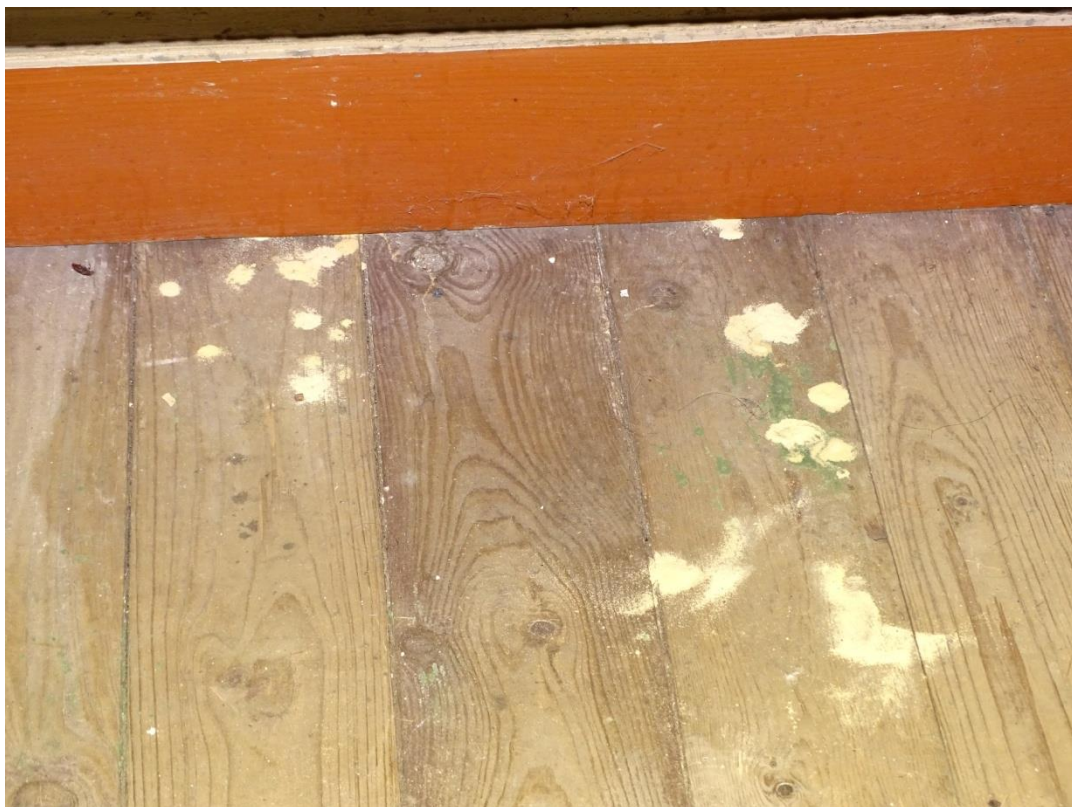
Fot. 29 Uszkodzenia w wyniku żerowania owadów.
