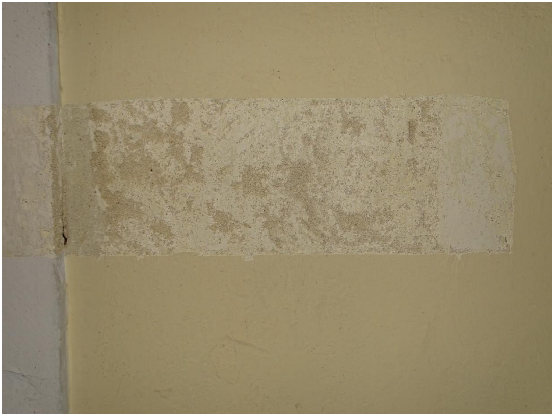
Fot. 45 Odkrywka 13 ściana w dolnej części zachodniej nawy
