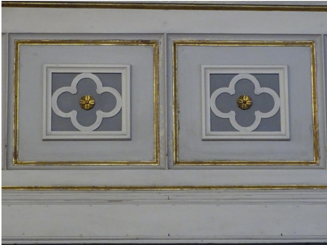
Fot.26 Zaoksydowany złożony detal na profilach sztukatorskich
