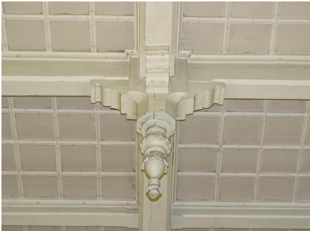
Fot.15 Zakurzona i zabrudzona powierzchnia stropu
