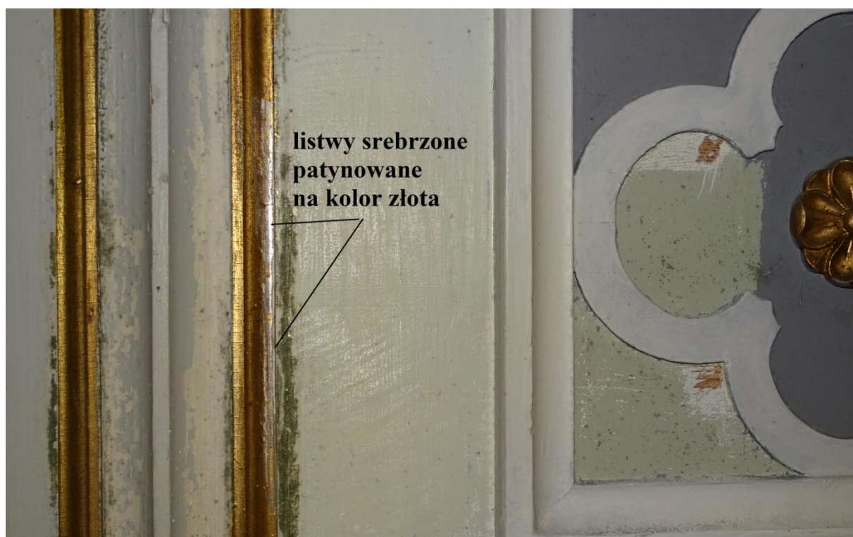
Fot. 66 Odkrywka 33 Odkrywka na powierzchni balustrady empory chóru z widocznymi srebrzeniami barwionymi na kolor złoty
