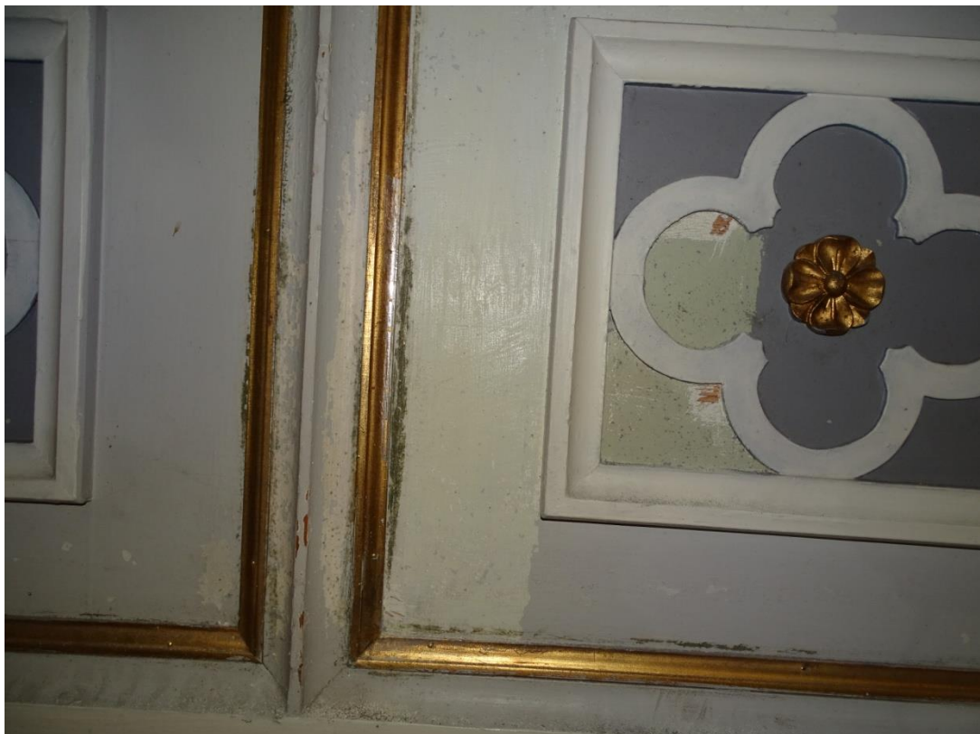
Fot.27 Przebarwione i zaoksydowane złączenia detalu sztukatorskiego
