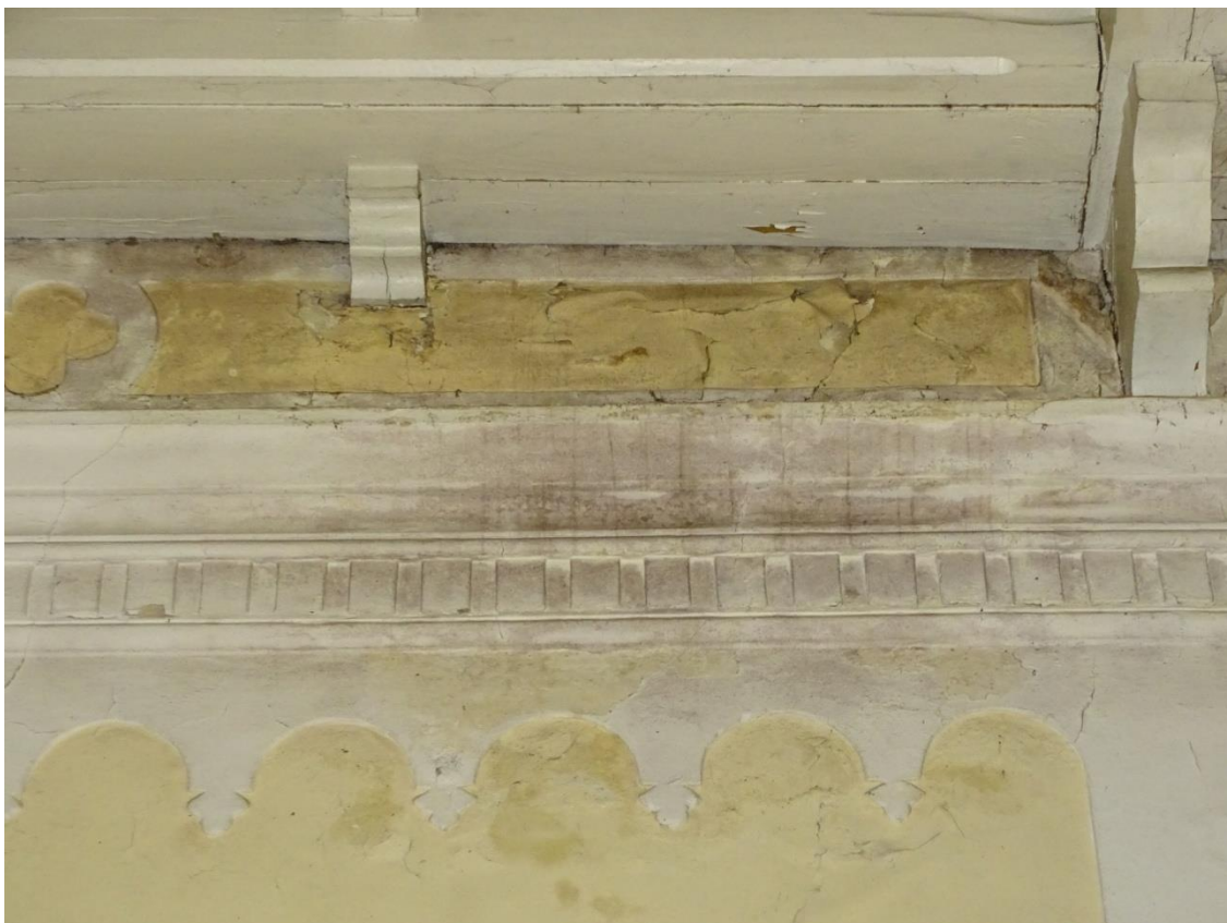
Fot. 24 Zacieki spowodowane skraplaniem się pary wodnej
