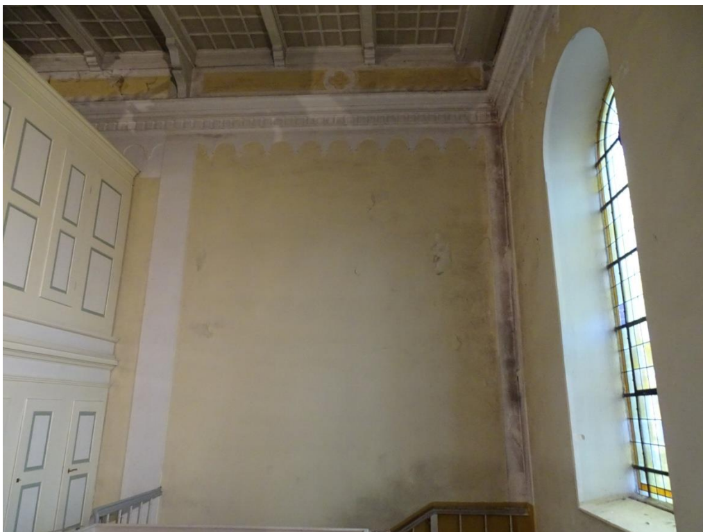
Fot. 16 Zły stan techniczny górnych partii ścian
