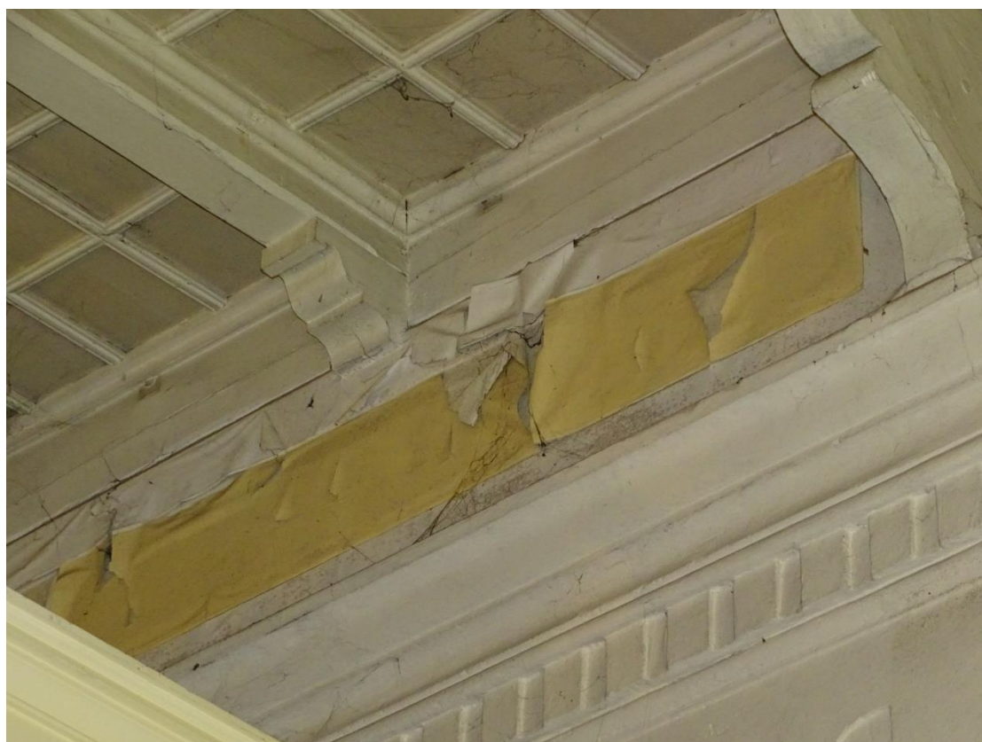
Fot.21 uszkodzenia warstw malarskich
