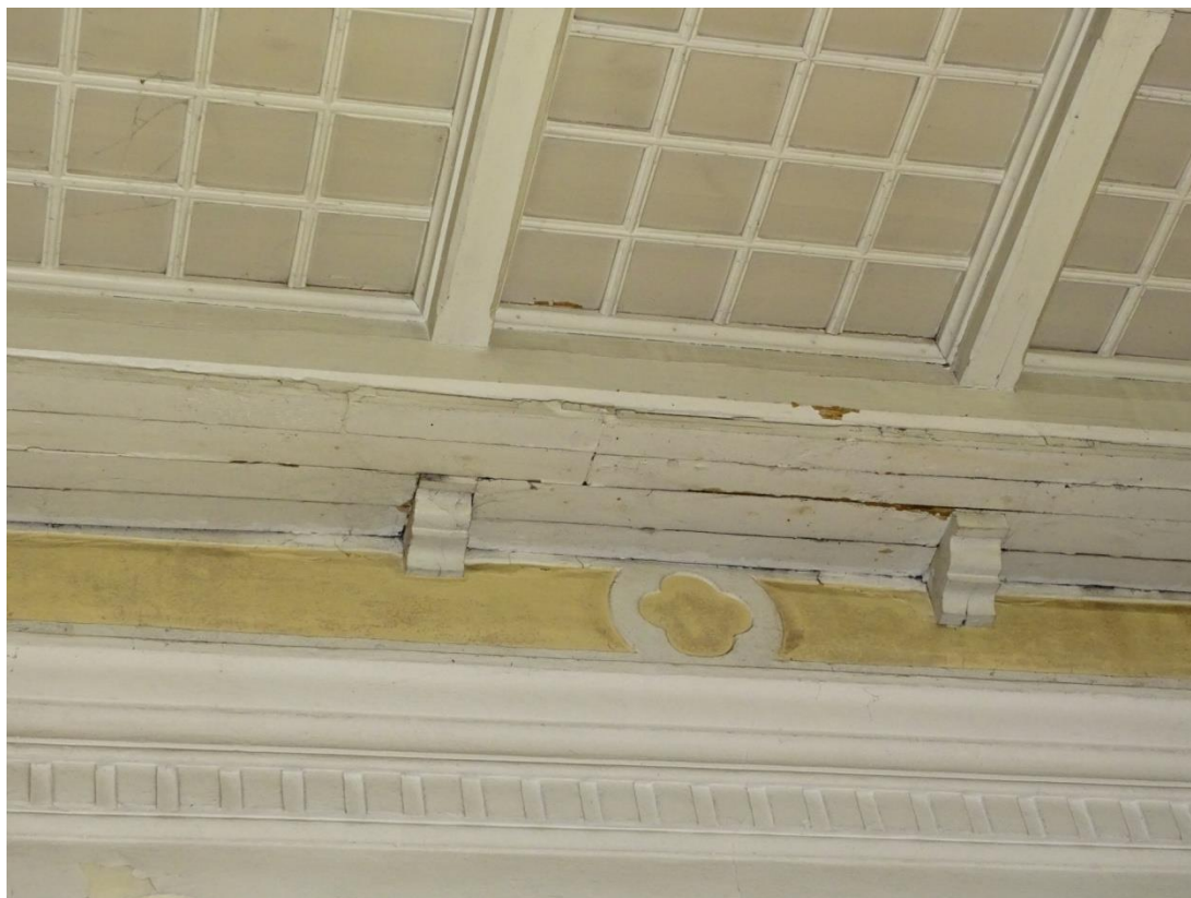
Fot.20 Uszkodzenia, spękania i rozwarstwienia warstw technologicznych stropu
