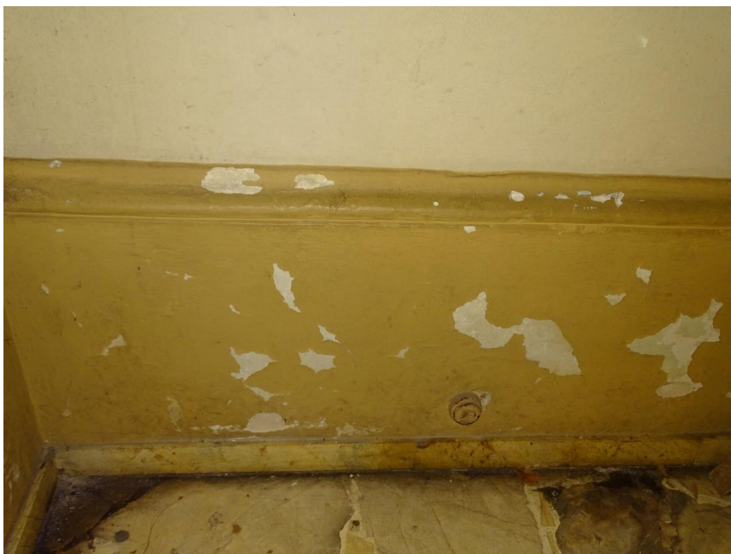
Fot. 19 Zły stan techniczny dolnych partii ścian, z widocznymi rozwarstwieniami powierzchni malarskich.
