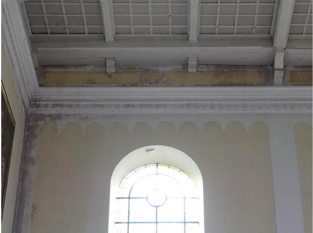
Fot.14 Zakurzona i zabrudzona górna część ścian i stropu
